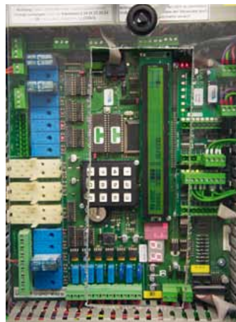
Steuereinheit einer Aufzugsanlage
