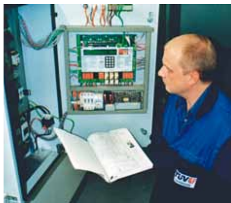
Prüfung der elektrotechnischen Einrichtung einer Aufzugsanlage
