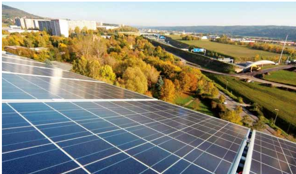
Photovoltaik-Anlage auf dem Dach des Wohngebäudes in der Werner-Seelenbinder-Straße 16 – 24
