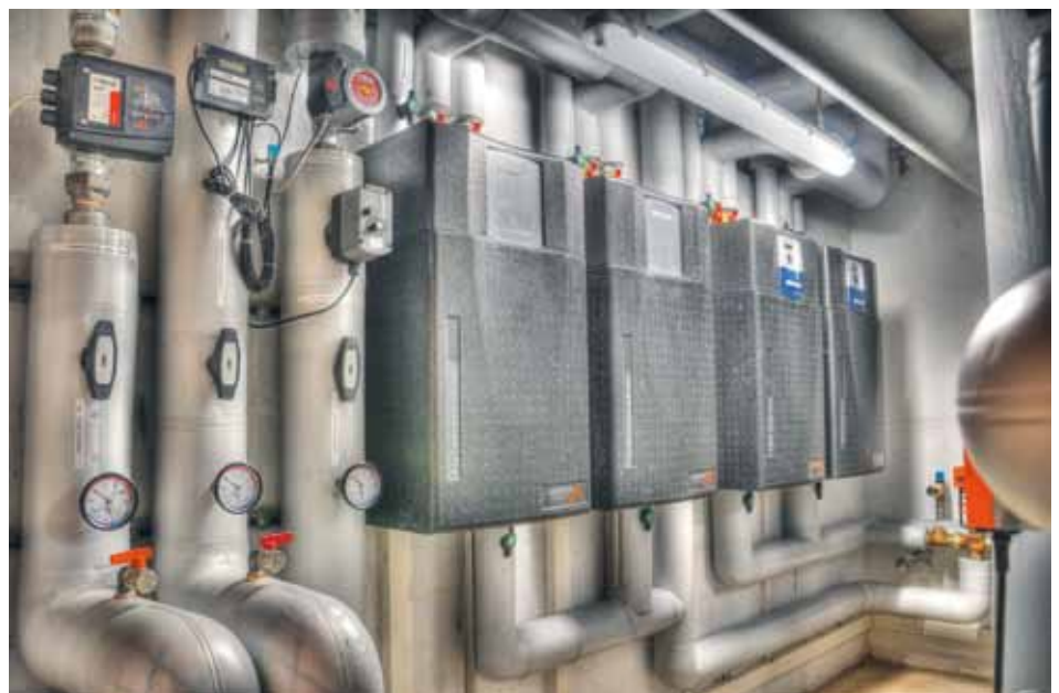
Blick in die Verteilstation
